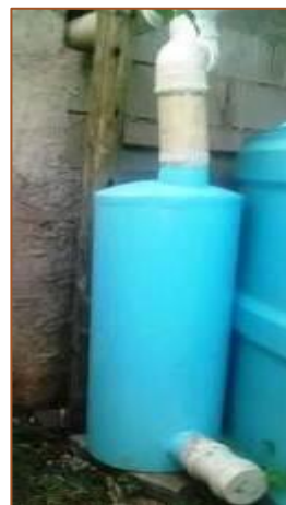
Figura 1: Sistema sedimentador-dreno para descarte dos primeiros milímetros de chuva que carregam as impurezas do telhado.
