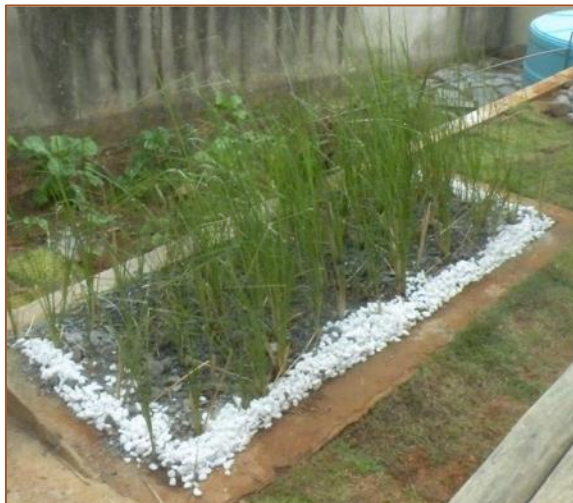
Figura 2: Sistema de tratamento AAC de fluxo horizontal e escoamento subsuperficial.
