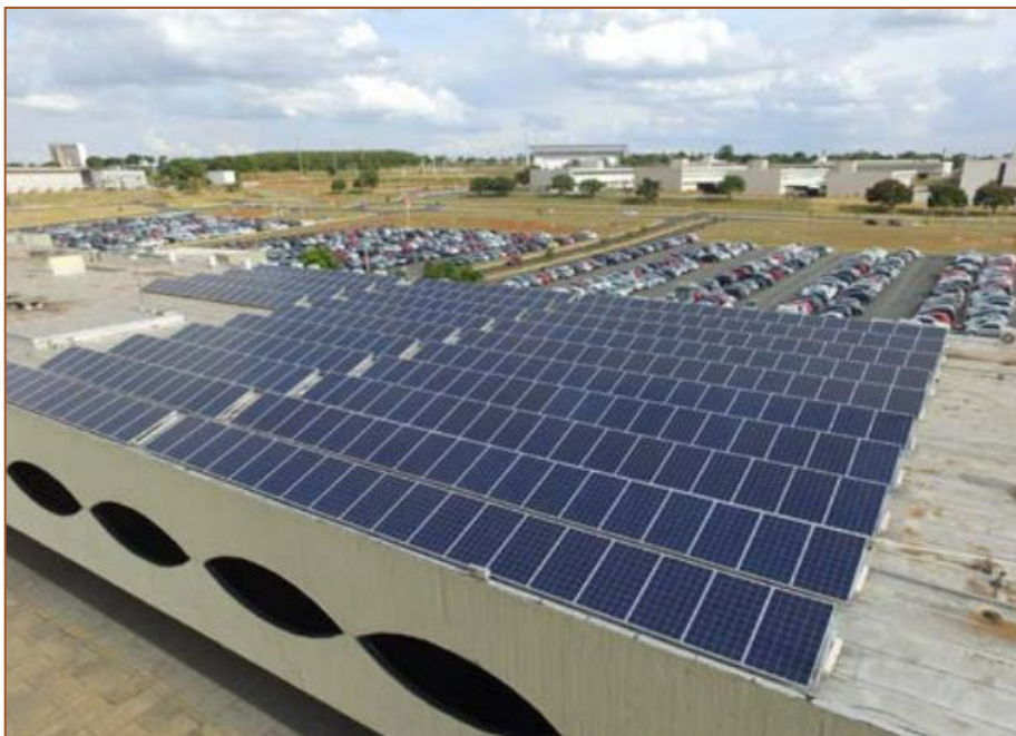
Figura 2. Uso de energia fotovoltaica no Quartel General do Exército Brasileiro -
