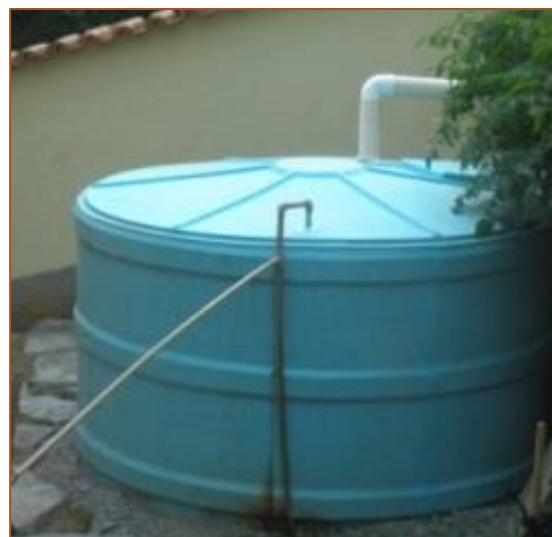
Figura 4: Reservatório hermético para armazenamento de águas cinza tratada e pluvial
