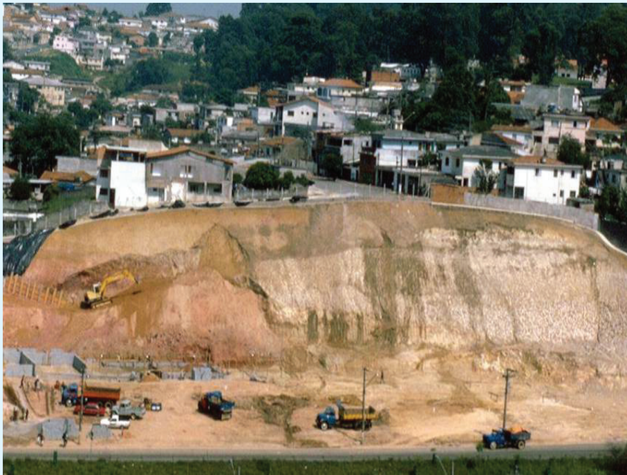
Figura 1. Talude instável em obra de implantação de posto de gasolina na Av. Escola Politécnica, São Paulo. Cobertura pedológica e tecnogênica sobre o embasamento cristalino (à esquerda) e sedimentos terciários (à direita). Foto: A.M.S.Oliveira, 1998.
