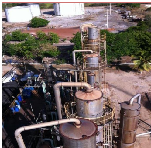
Figura 04 – Torres de Destilação
